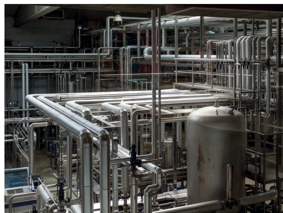
Обвязка технологических линий – проволочный лоток INOX (AISI 304)
