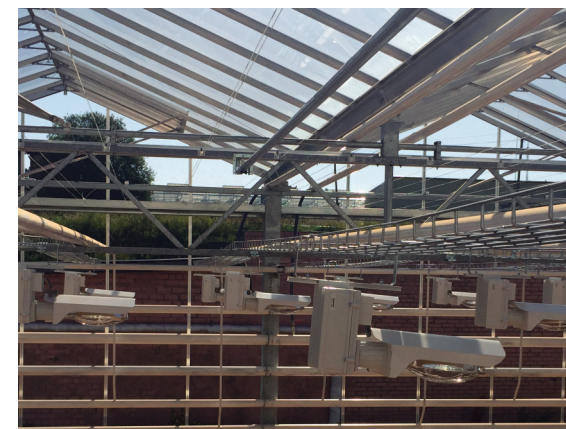
Система подвеса светильников на базе проволочных лотков
